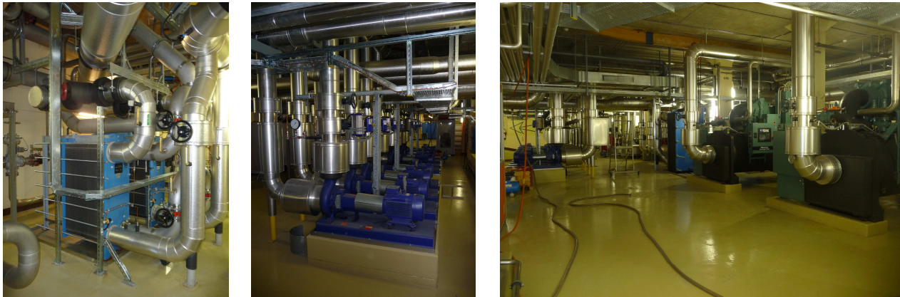
fig. 6-7 Sous-station d'un bâtiment connecté au réseau GLN: échangeurs de chaleur (à gauche), pompes de circulation (au milieu) et vue global avec machines frigorifiques (à droite)
