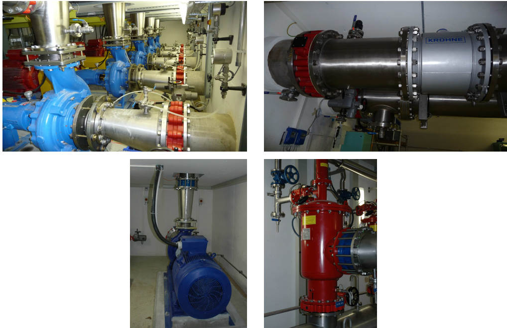
fig. 6-6 Station de pompage: filtres et chaudron GLN au 1 er étage (en haut), pompes GLN au rez (au milieu à gauche), conduites de distribution/retour avec débitmètre au 1 er étage (au milieu à droite), pompes et filtres Merck-Serono au rez (en bas)
