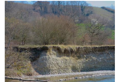
Figure f: érosion de la «Terrasse des Baillets» sur la rive gauche de l'Allondon, en aval du point d'observation Ge 5.2. Hauteur de la falaise: env. 5 m.
