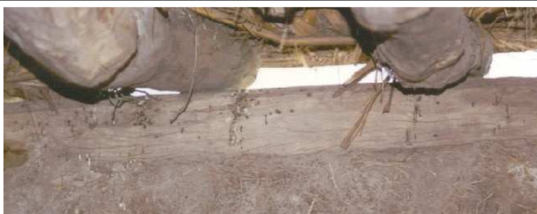
Photo 2 : Taches de déjections des vinchucas sur un mur, près du toit. Photo M. Sanmartino
