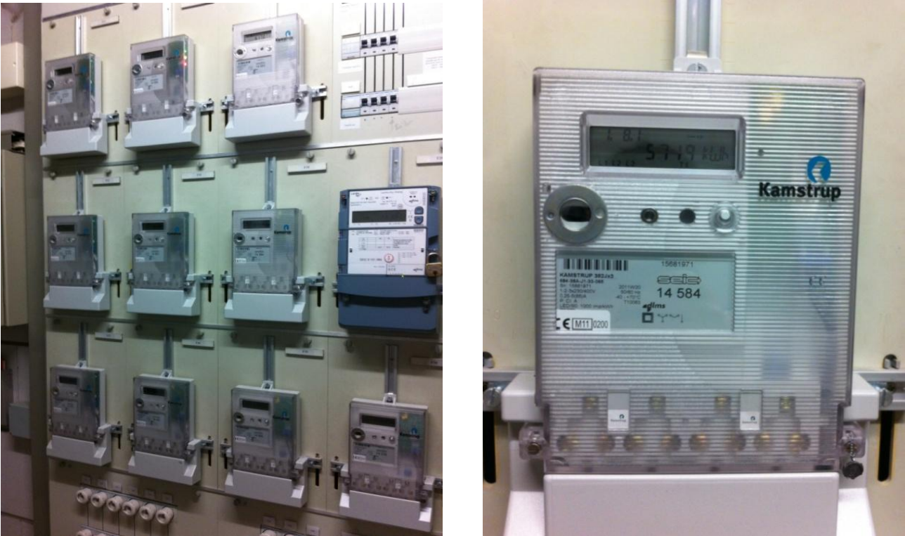
Figure 9 : Compteur communicant Kamstrup et local technique d'en Brex
