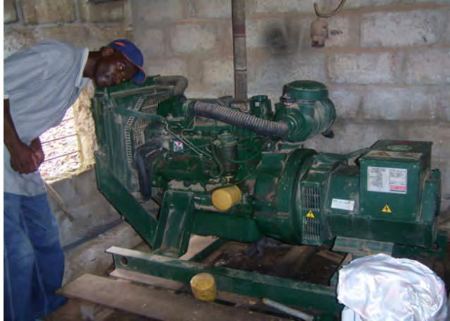
Figure 18 : Enclenchement de la génératrice des ateliers de formation
