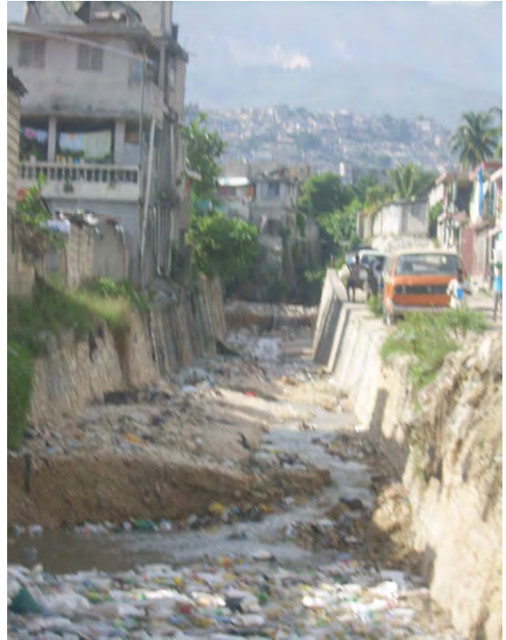
Figure 3 Canal à Port-au-Prince
