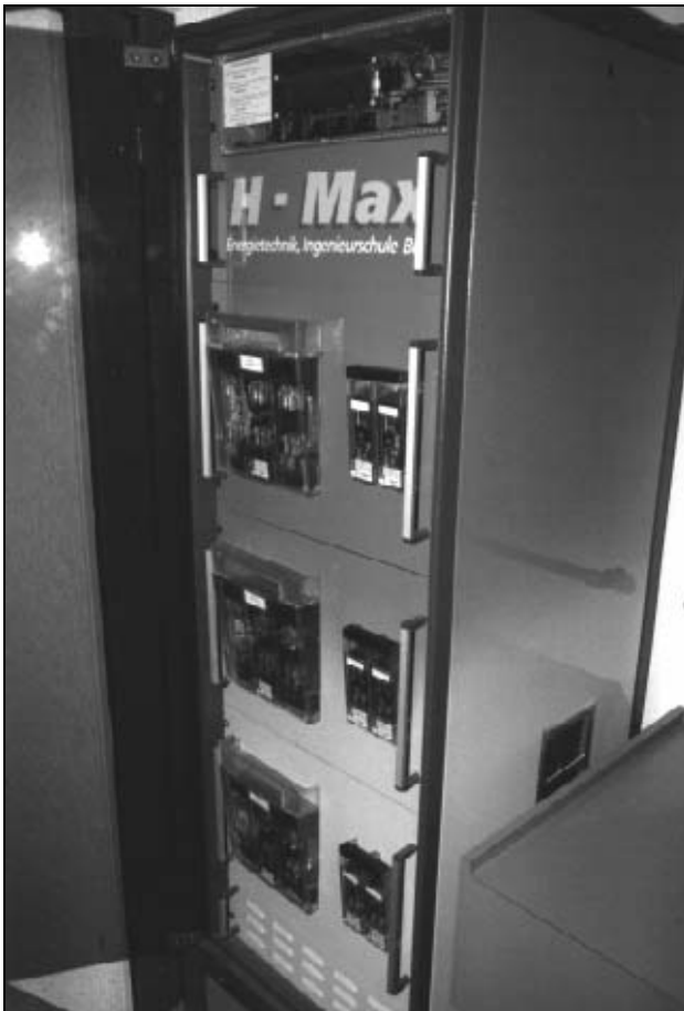
Figure 3: Transformateur DC/DC permettant d'adapter de manière optimale la puissance photovoltaïque à la caractéristique de l'électrolyseur, respectivement des accumulateurs. Sur le panneau avant on distingue les fusibles permettant de sélectionner le mode d'utilisation désiré.
